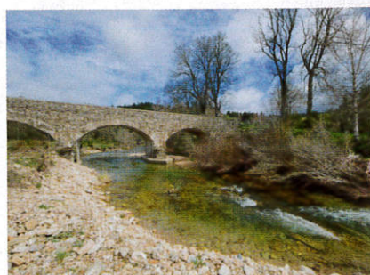
Pont sur le ruisseau de Masméjean, près du petit hameau de Labrot, à Luc.
